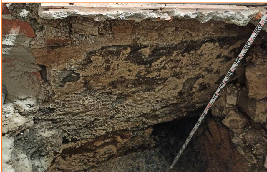
Foto 2. Alçat de la fonamentació del mur UE 5, i el seu negatiu constructiu UE 10 (part inferior)) que tallava les argiles UE 8. A la part superior es pot observar l'arrasament horitzontal UE 7. A la dreta, reompliment de runa UE 4.
